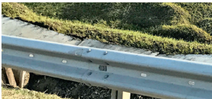
Разрушающаяся обочина дороги у Керченского моста, апрель 2019 г.
