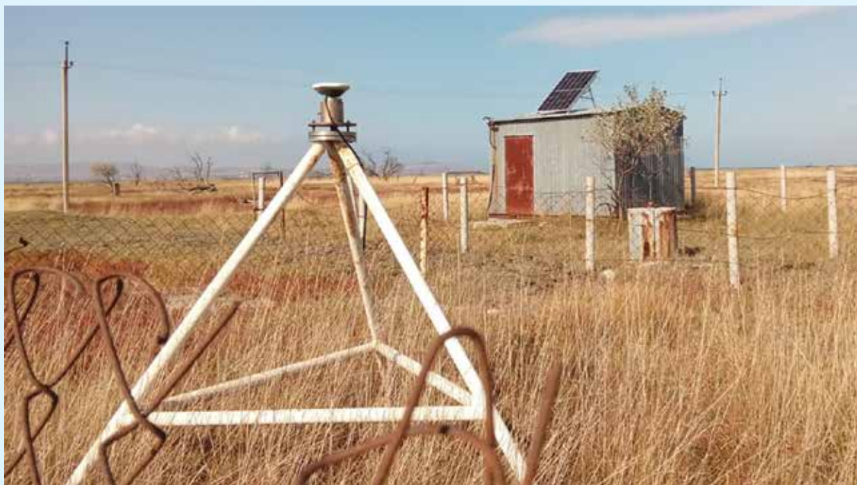
Рис. 49. СГП «Порт-Кавказ» в районе Крымского моста с автономным электропитанием от солнечной станции
